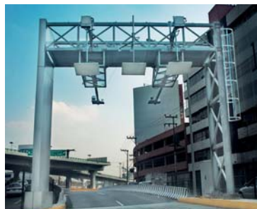
Sistema free-flow, implantado por Indra en el Viaducto Elevado Bicentenario de México.
